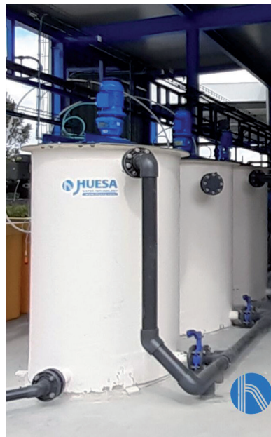
FIGURA 3. Vista de las cámaras de coagulación, neutralización y floculación
