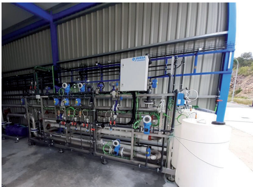
FIGURA 6. Vista de la parrilla de difusores. Reactor biológico
