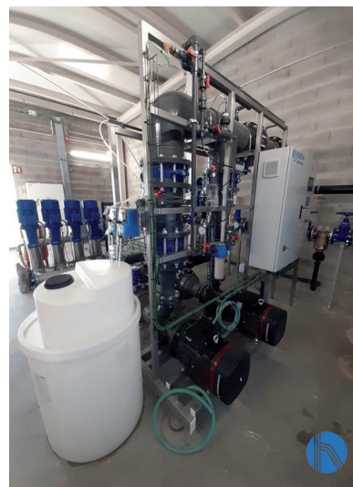
FIGURA 2. Vista de la planta de aguas
