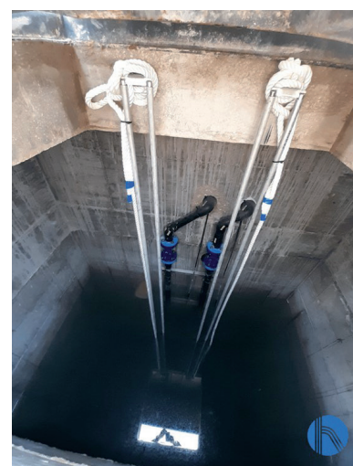
FIGURA 1. Pozo de bombeo balsa 5
