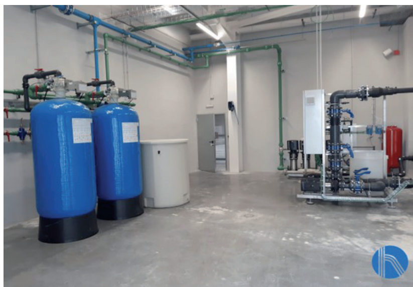
FIGURA 4. Vista de la planta de aguas en la nave de envases
